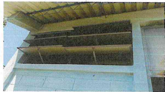
Foto 4: Ventanas en mal estado
