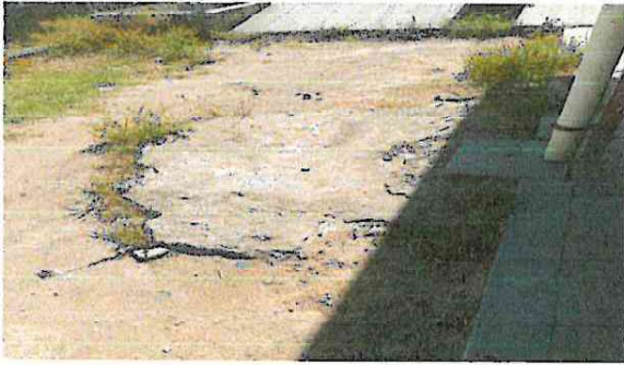
Foto 1: Deterioro de plancha de concreto
