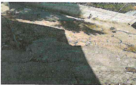
Foto 5: Paso conector de módulos en malas condiciones
