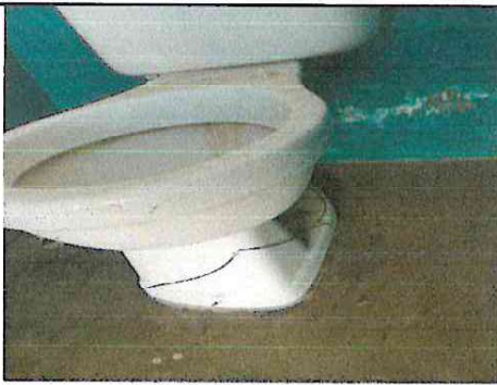
Foto 3: Sanitarios en malas condiciones
